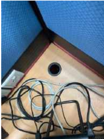
Penemuan: Kabel tidak dikemas dan meja berhabuk
